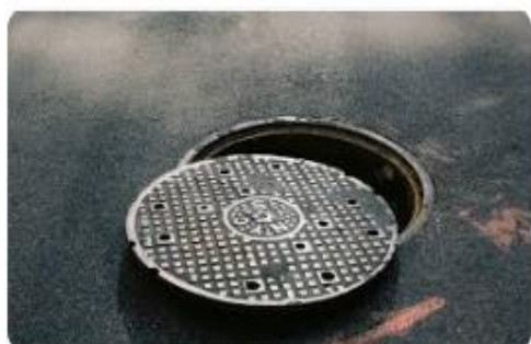
Poklopac kanalizacione mreže u saobraćajnom putu [3]
