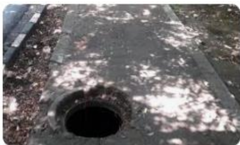
Kanalizaciona mreža bez poklopca u saobraćajnom putu [3]
