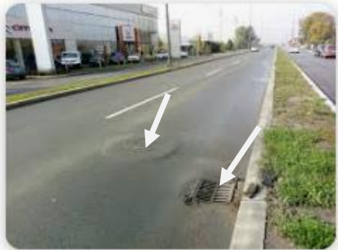
Rrjeti i kanalizimit në rrugën qarkulluese [3]
